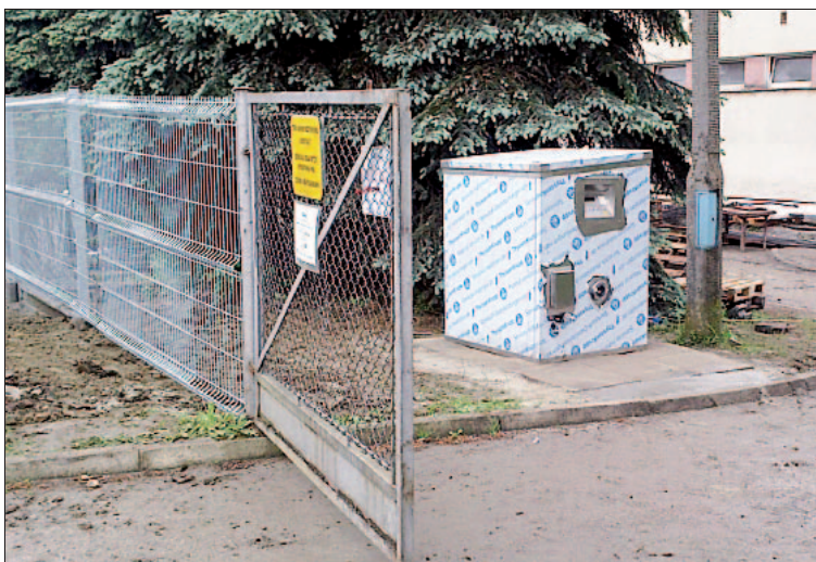
Wodomat na terenie stacji w Lubaszowej
