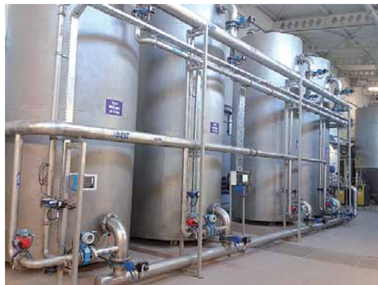
Stacja uzdatniania wody Lubaszowa – urządzenia technologiczne.
