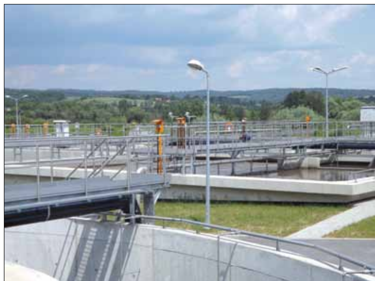
Oczyszczalnia ścieków w Tuchowie – urządzenia technologiczne.
